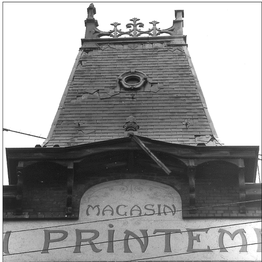
Couverture en ardoise et toit en pavillon. Décoration: petits carreaux de céramique (mosaïque) à décor végétal, tige et enroulement, avec l'inscription MAGASIN/AU PRINTEMPS (vraisemblablement des années 30).
